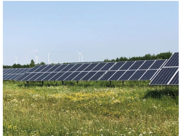
Zwei große Freiflächenanlagen mit 2,3 und 3 MW Leistung sind seit 2012 am Netz, hier ein Bild der Anlage Langenzenn, im Hintergrund die Anlagen der Bürgerwind-Langenzenn.
